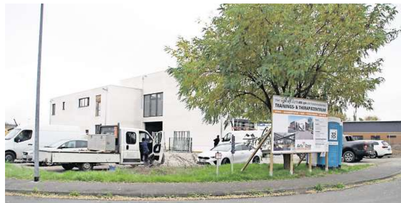
Die Hülle des neuen Therapie- und Trainingszentrums steht. Doch bis zur geplanten Eröffnung im März bleibt noch einiges zu tun.
