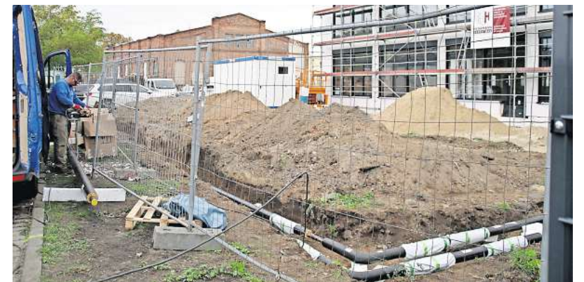
Die neue Aktiv-Oase wird mit Fernwärme beheizt. Derzeit werden dafür die Rohre verlegt.
