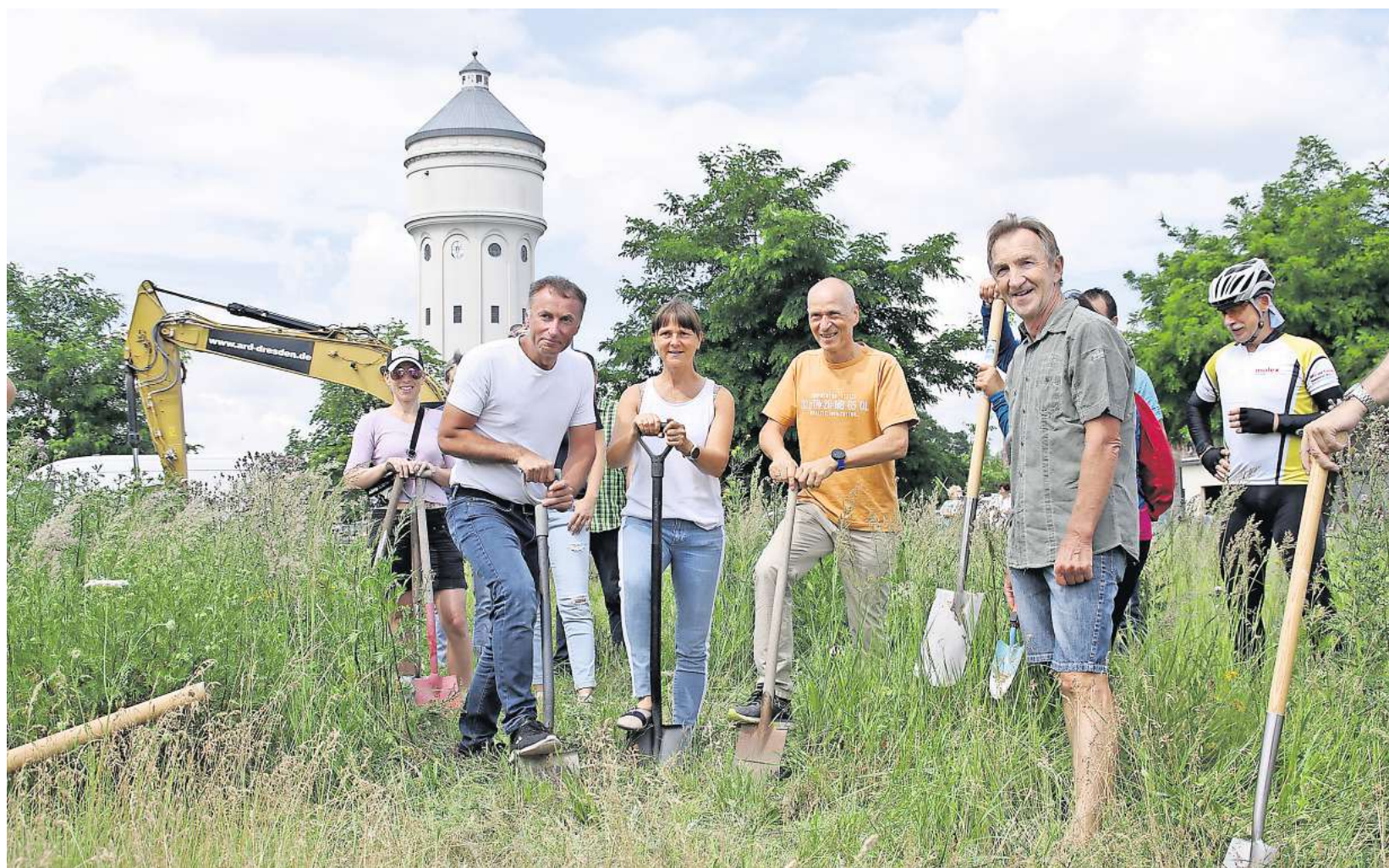
Bauplaner René Schwallier sowie Petra und Dirk Heynig (von links) vollziehen in Sichtweite des Eilenburger Wasserturmes den offiziellen Spatenstich für das neue Trainings- & Therapiezentrum. FOTOS: ILKA FISCHER/WOLFGANG SENS
